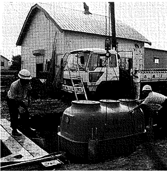
合併処理浄化槽
